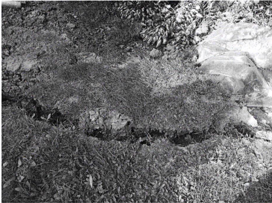
szczelina nad skarpą główną na zachód od tarasu
