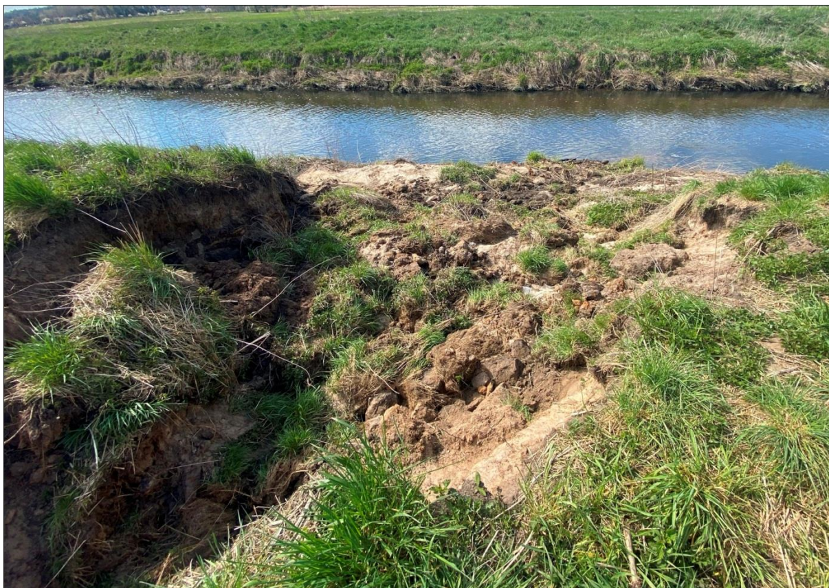
Fot. Nr 1. Przerwana grobla okalająca główny nurt rzeki
